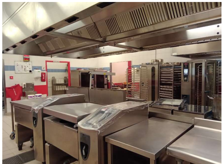
Salle de cuisson avec fours, braisières, friteuses...
